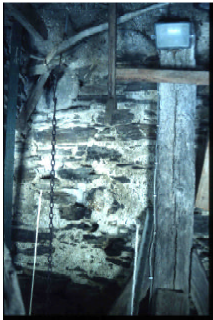
Fig. 3 - Vue du beffroi de Roquefère (Aude), en mauvais état.
